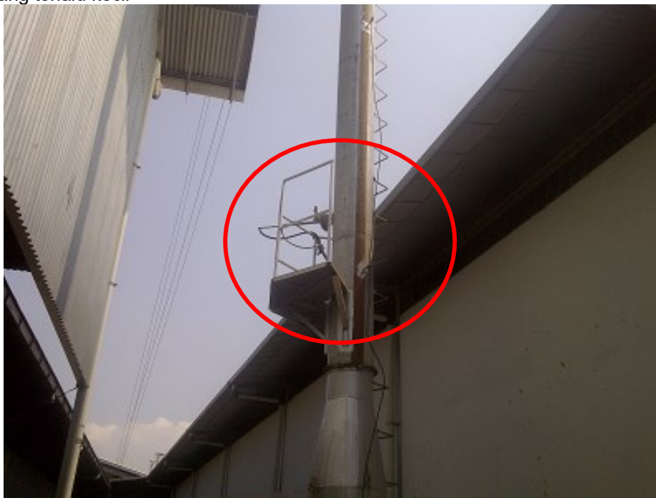
Gambar 8. Penampang Bordes yang Terlalu Kecil
